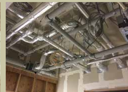
二重天井配管(居室棟)
