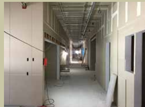
二重天井配管(廊下)
